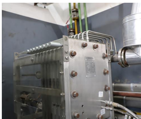
G4 – Actual Installation
