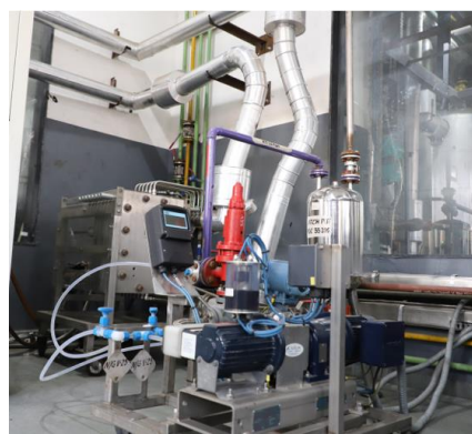
G4 – Actual Installation
